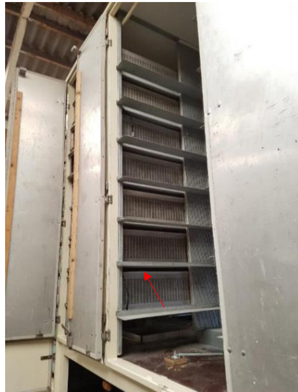
Locatie sensoren voorin (tussen de derde en vierde kolom van voren)
